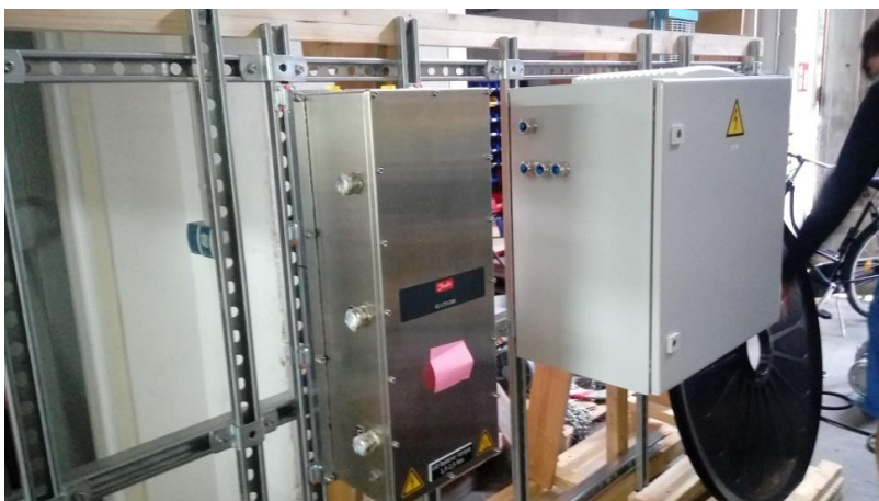
Abbildung 18: Schaltschränke der Phase2-Anlage
